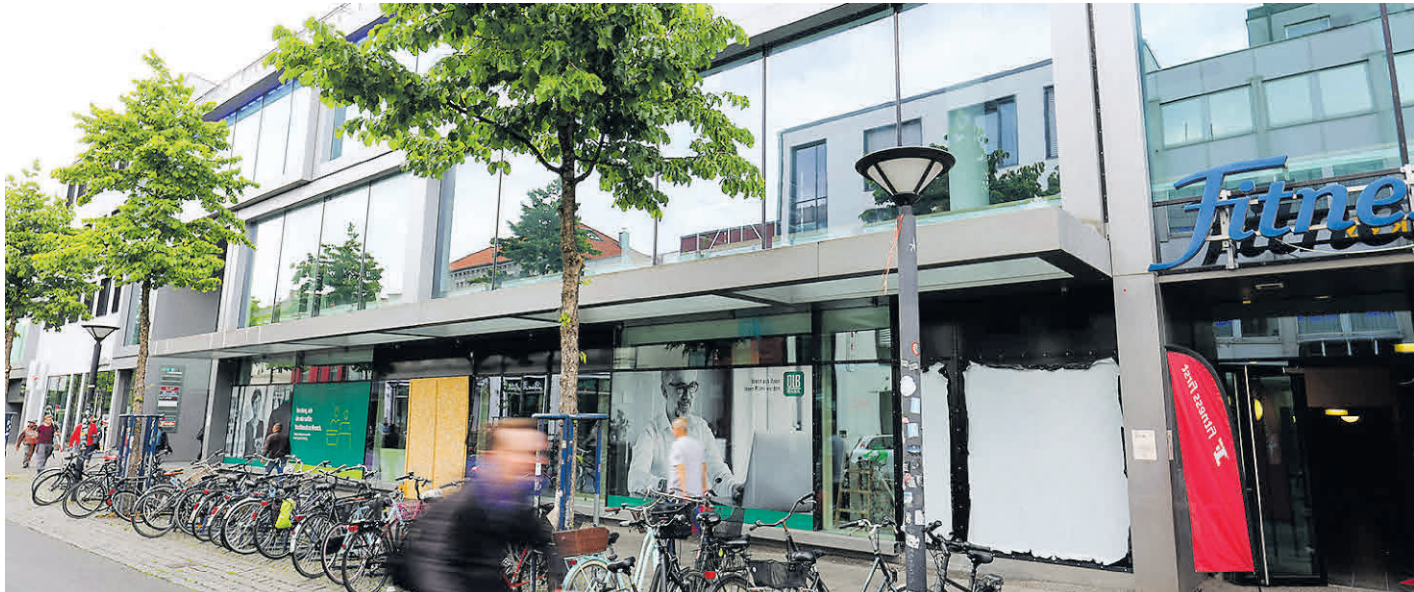
Lange Leerstelle, jetzt Baustelle: Ab Januar soll links auf der ehemaligen Spielmax-Fläche „Core“ einziehen, auf der ehemaligen Saturn-Fläche rechts entsteht das neue Beratungszentrum für Finanzdienstleistungen der OLB. BILD: MARTIN REMMERS
